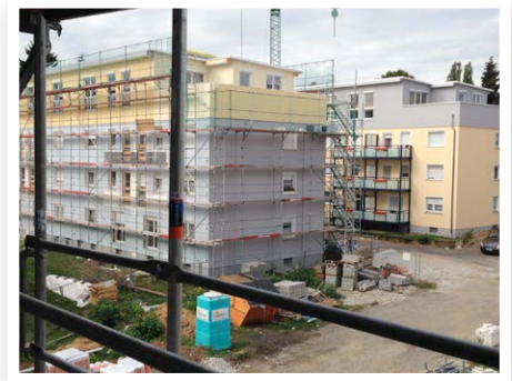
Wohnquartier Kronberger Carrée in Bad Homburg: Sanierung Altbestand, Anbau von Balkonen, Neubau von Dachgeschosswohnungen
